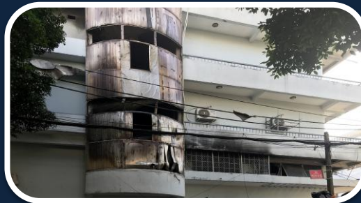
Căn nhà 5 tầng bốc cháy ở Quận 11 (05/11/2020)
