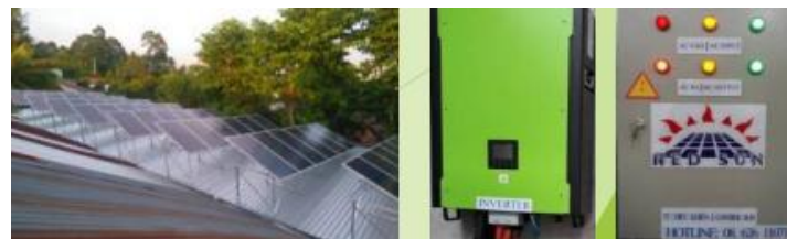
Hệ thống năng lượng mặt trời 12kW
